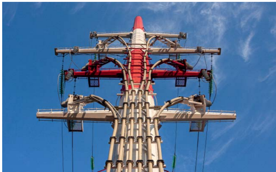
Рис. 3. Переход силового кабеля с кабельной лестницы на траверсы и ввод в муфты
